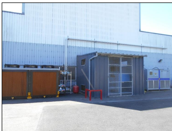
Groupes froids et local compresseur
