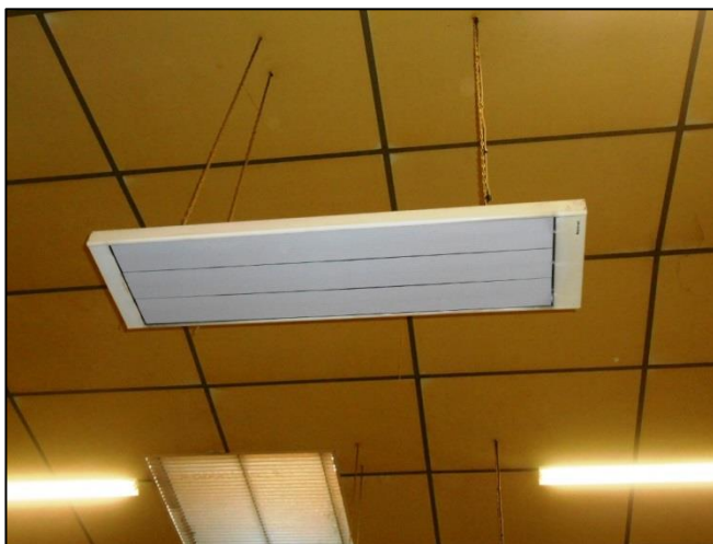
Radiant électrique au niveau de l'atelier soudure
